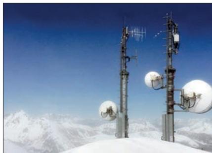
Bild 2: Installation der K552921 hoch in den Alpen (Foto: Wolfgang Schnoor)
