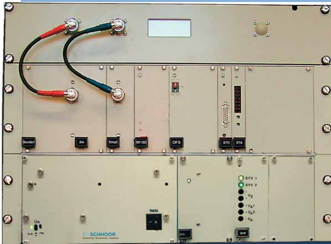
FSO-PMR mit Ladegerät und Schaltmessfeld
