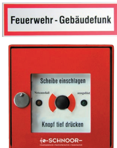
Beispiel für ein Bedienfeld nach den Anforderungen der Berliner Feuerwehr
