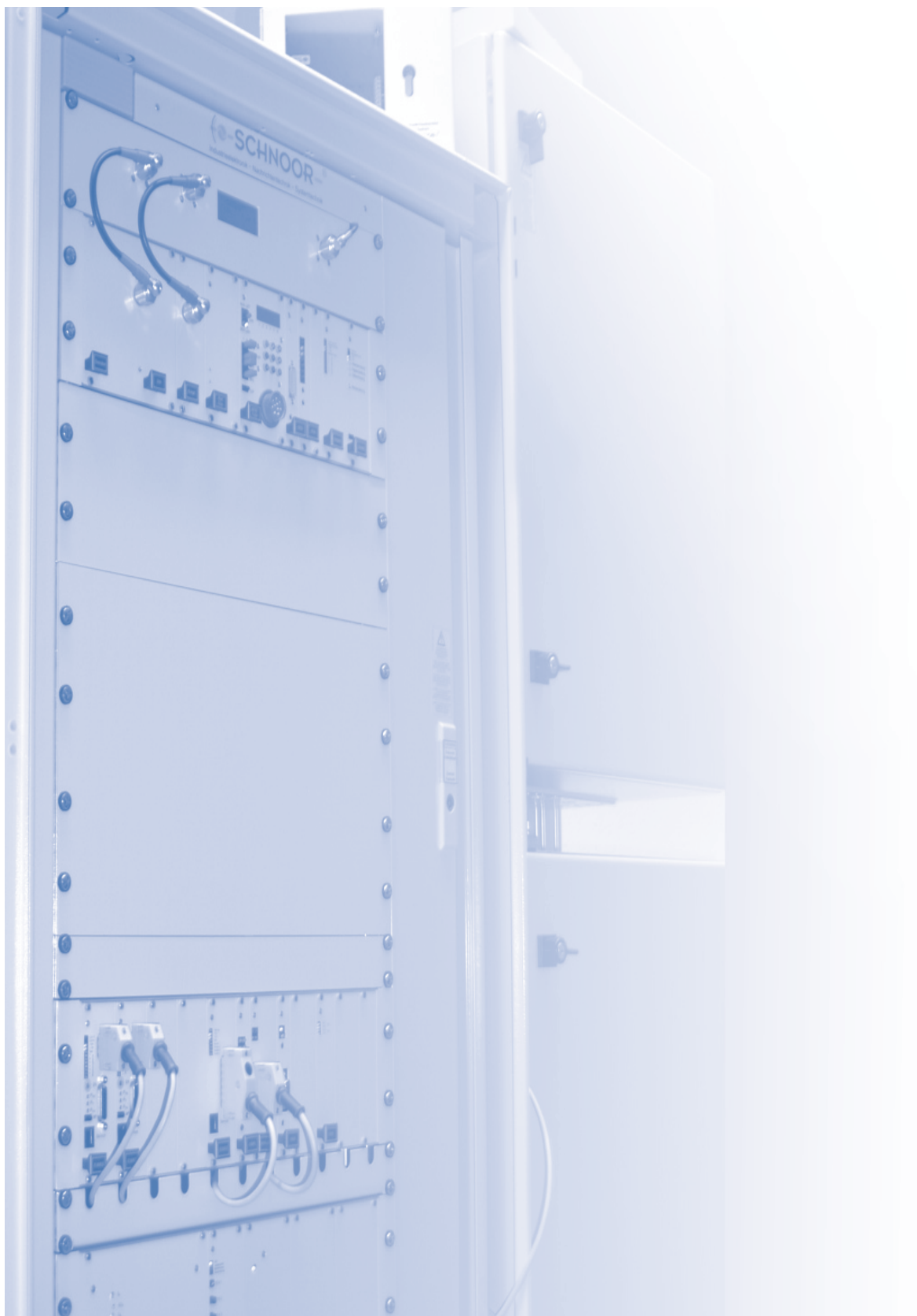
Funkanlage mit Diversity im 19"-Funkschrank
