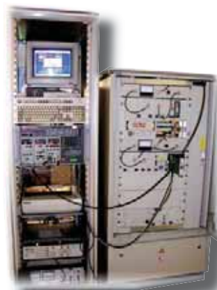
Endprüfung eines Funkschranks
