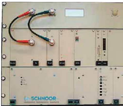
FSO mit Ladegerät und Schaltmessfeld
