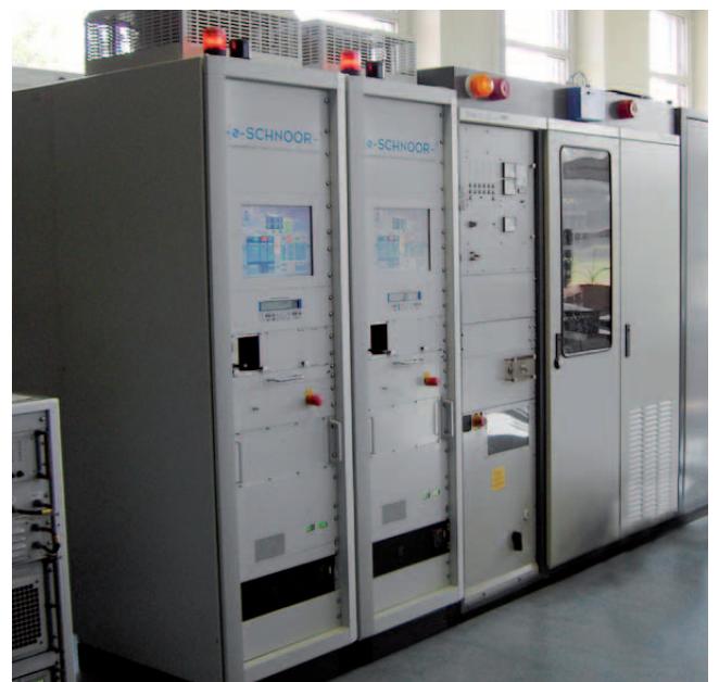
NAVTEX Transmitter beim DWD in Pinneberg
